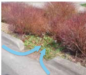
縁石に切れ込み
